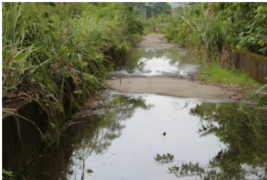
2、3 號沉澱池間混凝土道路在雨後有積水的情形。
