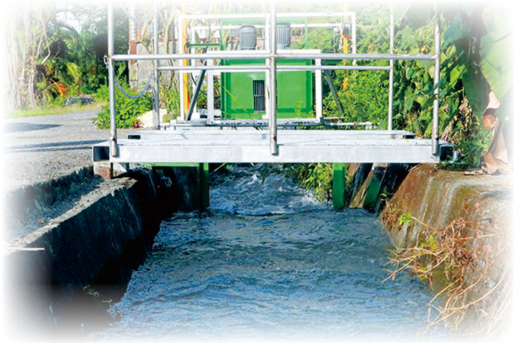
(花蓮福慧農場 微水力發電設備 - 圖片來源：台灣電力公司提供)
