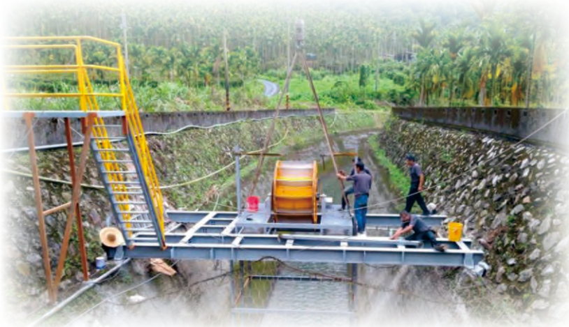
(向天圳微水力發電機組 - 圖片來源：經濟部水利署提供)
