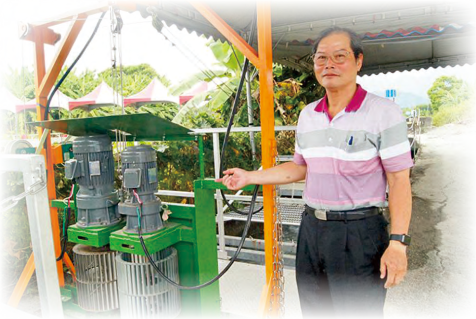
（花蓮福慧農場 微水力發電設備 - 圖片來源：台灣電力公司提供）
